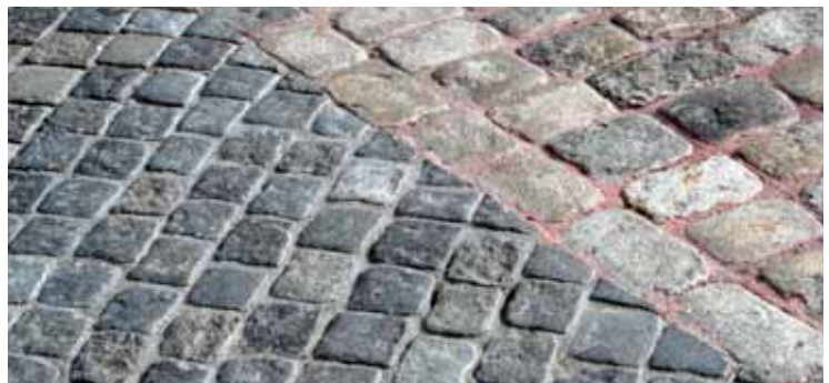
Flowpoint fuger. Fuget én gang for alle - for ca. 5 år siden...
