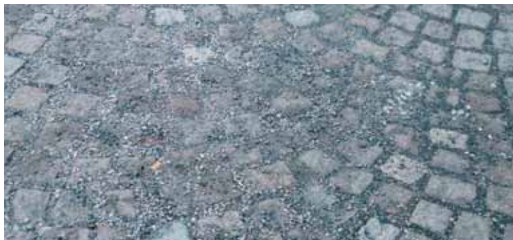
3. gangs refuget felt med korning i fugene. Er det slik DU vil ha det?
